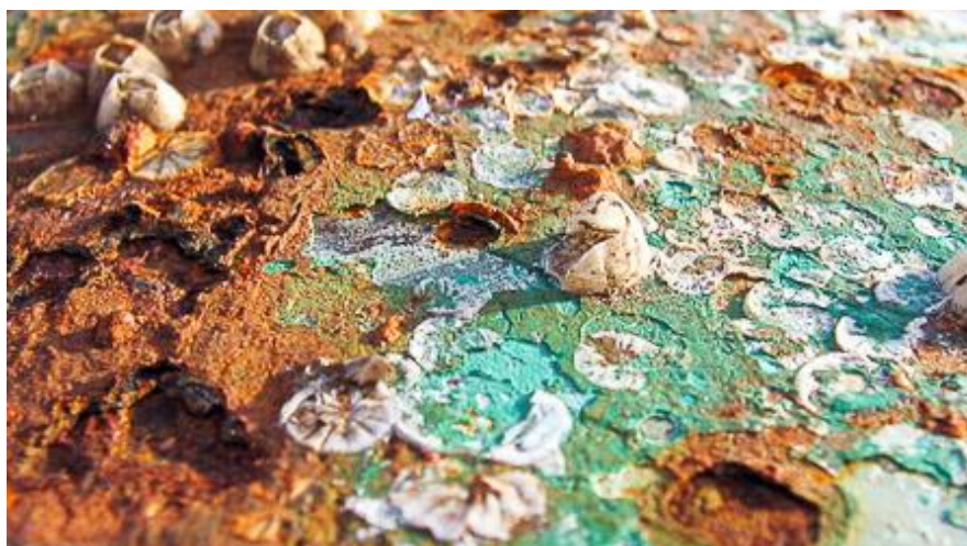
Fot. 17. Biokorozja metalu powodowana przez mikroorganizmy
