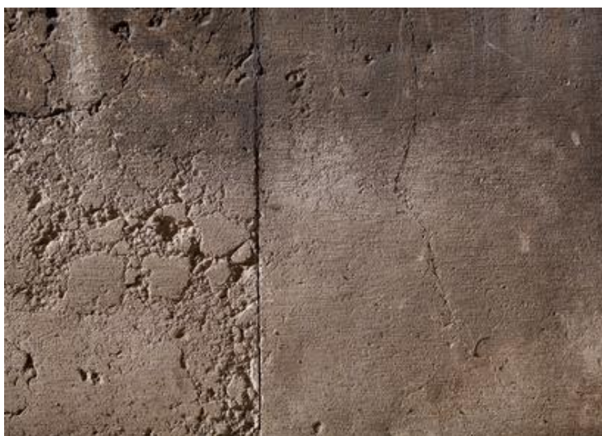
Fot. 16. Mikrobiologiczna korozja betonu
